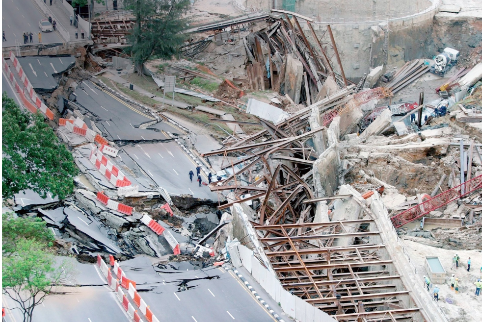
Abbildung 1: Einsturz Baugrubensicherung Nicolls Highway 2005 (KOLYMBAS, 2016)
